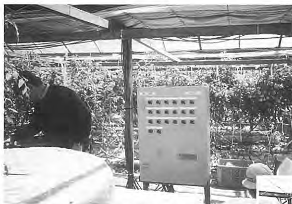
現場制御パネル
